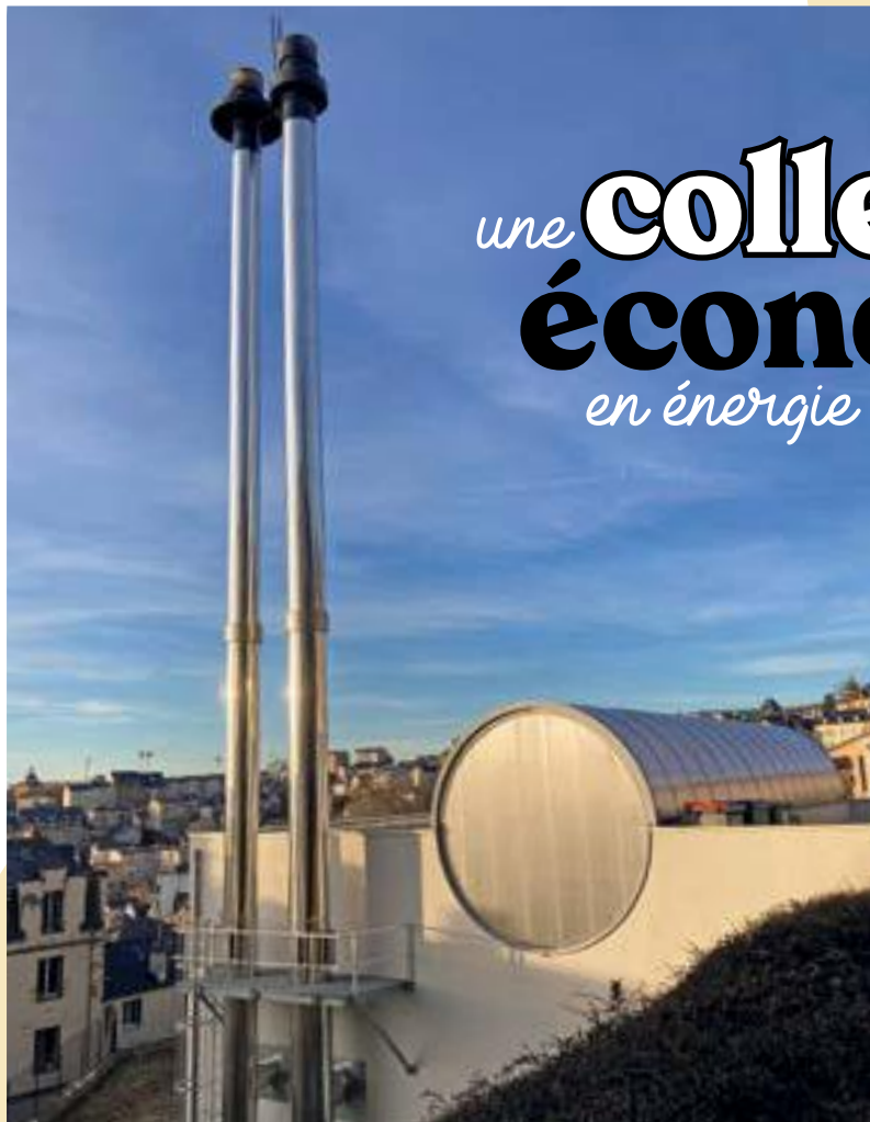
Chaufferie rue Sarrus à Rodez
